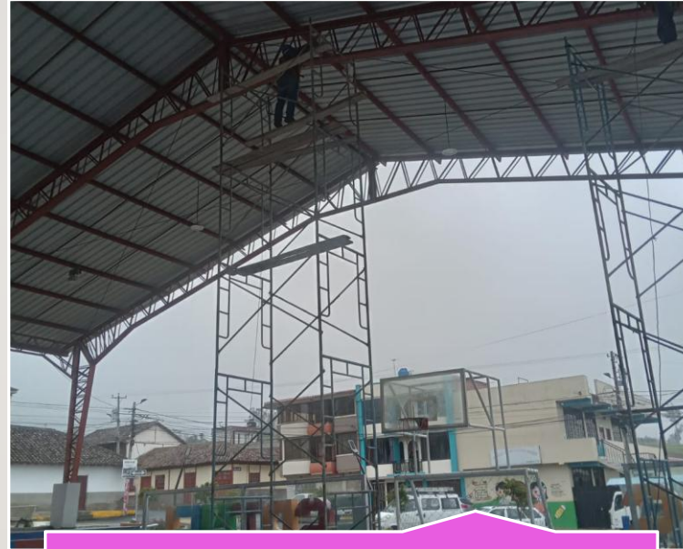
SUMINISTRO E INSTALACION DE LUMINARIAS LED TIPO UFO DE 200 W
